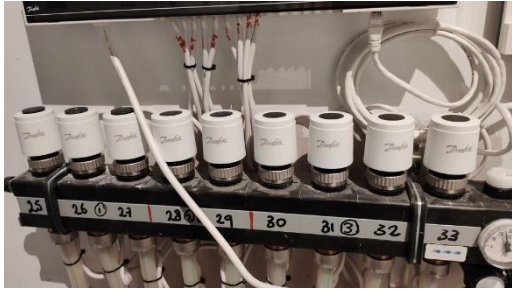
De motoren voor naregeling van de vloerverwarming.
