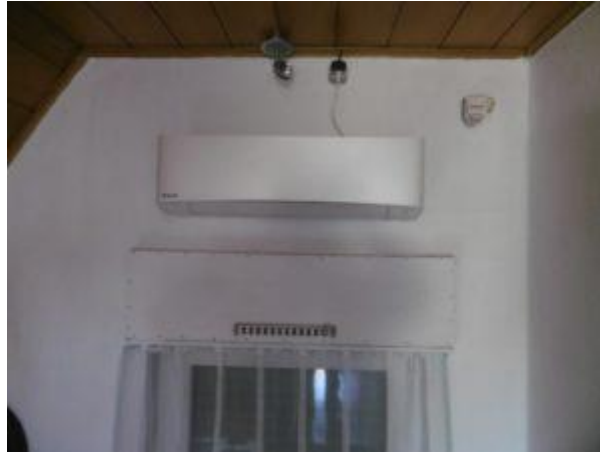
De airco-unit op de eerste verdieping.
