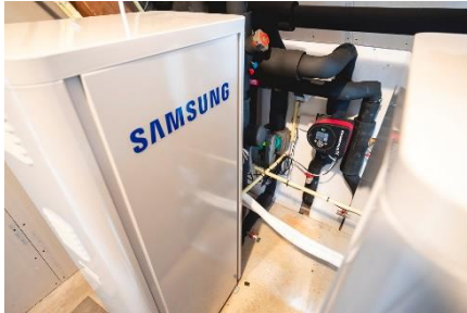
De twee binnen opgestelde units van de 25kW-warmtepompsystemen.
