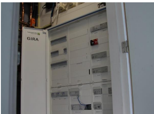
De schakelkast in de technische ruimte. Als elektromonteur heeft Roos allerlei zaken in zijn huis geautomatiseerd.
