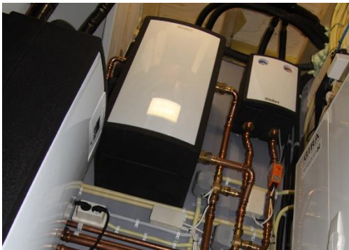
De installatieruimte met warmtepomp.
