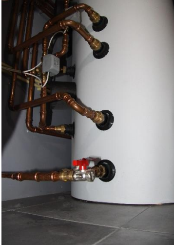
Het 300 liter grote buffervat dat aan de warmtepomp is gekoppeld.
