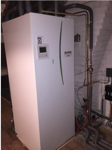
Binnenunit van de CO 2 -warmtepomp.
