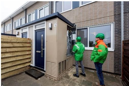
BAM-energiemodule in een van de pilotprojecten.
