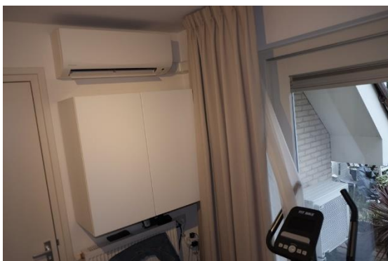
De 2,5kW-airconditioner in de slaapkamer met de buitenunit aan de andere kant van het raam.
