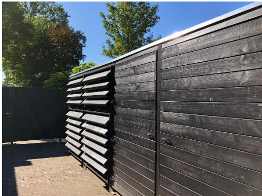
De buitenunit van de warmtepomp van Rudy Grevers staat opgesteld in een schuurtje.
